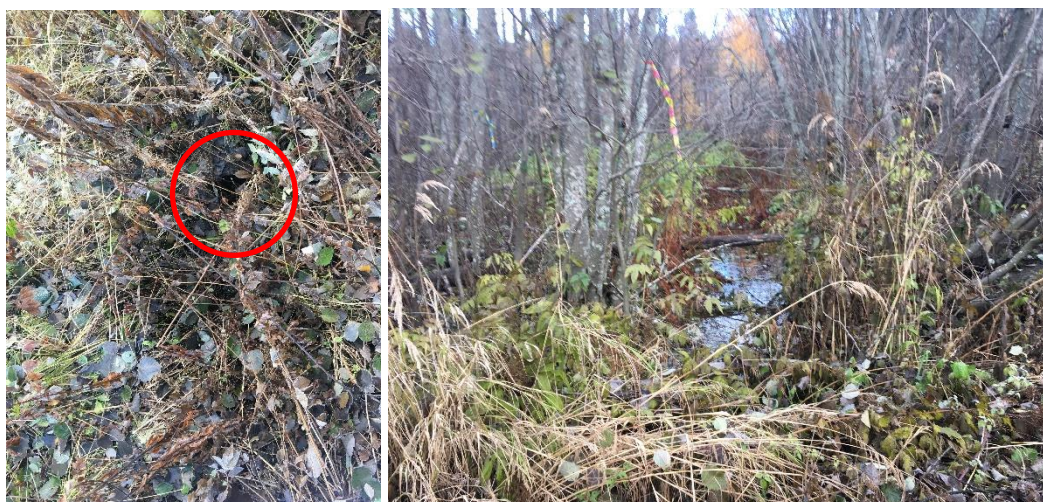
Figur 9: Inlopp till sydvästra trumman (D) under järnvägen samt diket nedströms med vy mot trumman. Båda är i behov av rensning.
