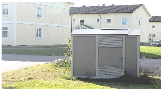
Transformatorstation vid Modistvägen söder om planområdet.
