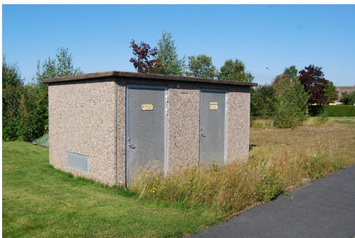
Transformatorstationen vid Per Thams gatan.
