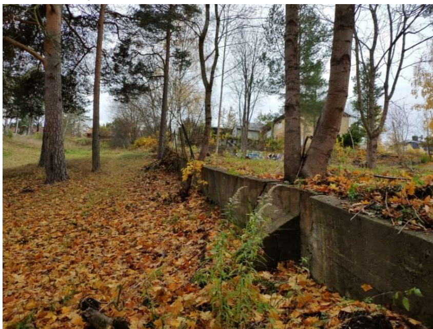
Muren är i dåligt skick och behöver bytas i samband med nybyggnation
