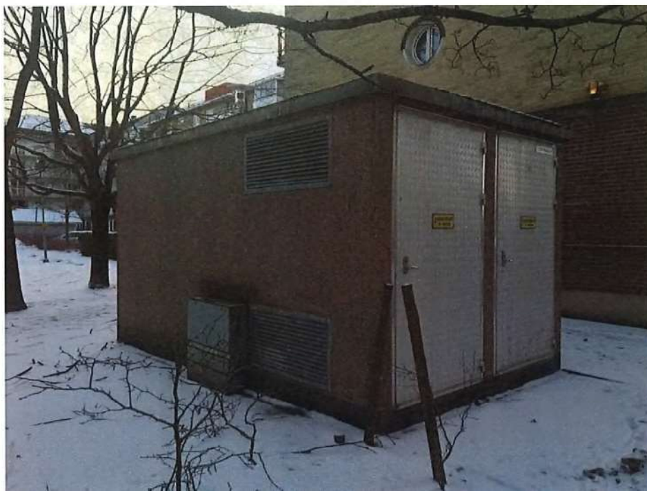
Bild: Kristinehamns energis transformatorstation.
