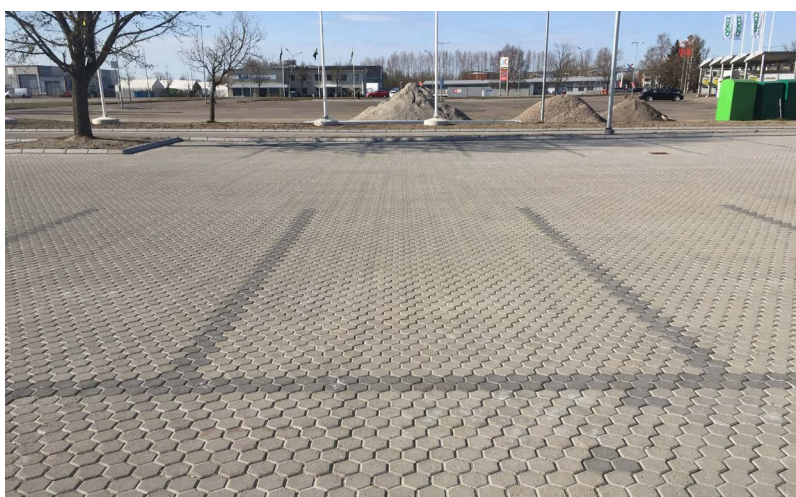
För bättre dagvattenhantering har delar av parkeringen utformats med fler träd än tidigare samt marksten som har bättre genomsläpplighet än asfalt. (Foto: Skara kommun, 2019)
