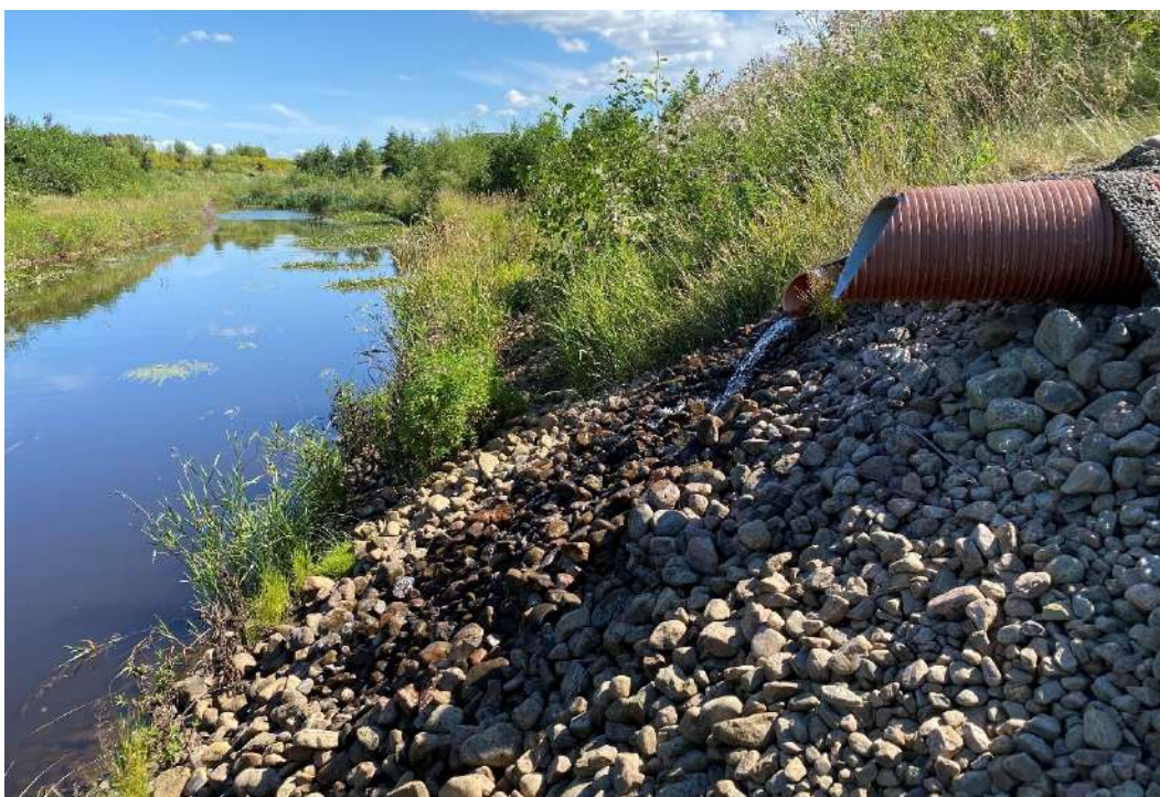
Figur 41, Erosionsskydd vid utloppsrör.
