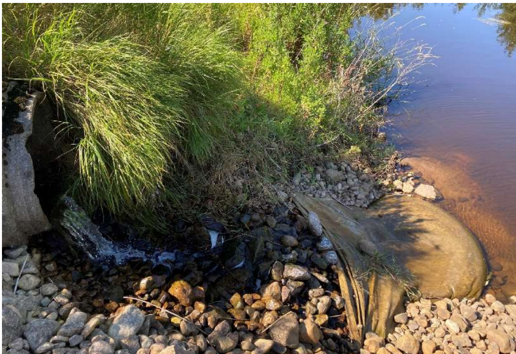
Figur 40, Skadat erosionsskydd. Vatten rinner in under duken och bildar "kuddar" av vatten.
