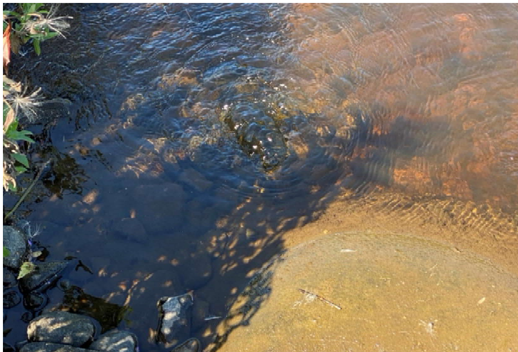
Figur 44, Skadat erosionsskydd. Vatten sipprar ut genom duken från en vattenfylld "kudde".
