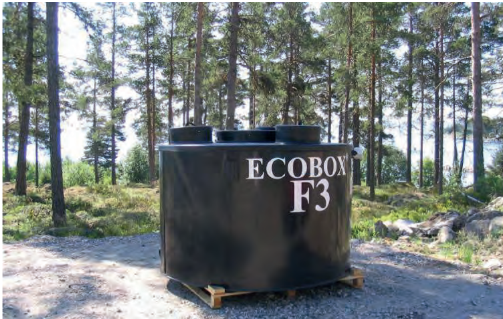
Bild 33. Godkänt minireningsverk av miljökontoret
