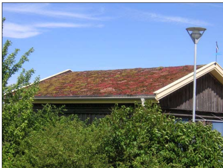
Sedumtak, som här på Frösakullsskolans förråd, fördröjer regnvattnets avrinning och minskar belastningen på dagvattenssystemet (Arkitekt: Creacon HKAB, Christine Rohde).
