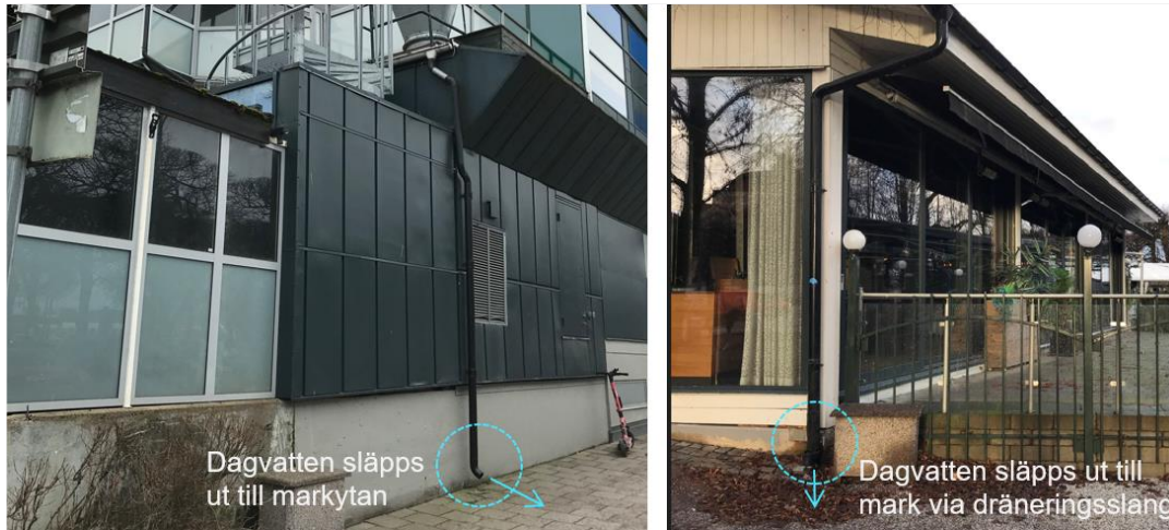
Figur 39. Bilden till vänster visar ett stuprör som avleder dagvatten från takytan på byggnaden i den nordöstra delen av fastigheten Stjärnan 16. Bilden till höger visar ett stuprör på samma byggnad som leder vatten till en underjordisk ledning. Foto: Jackie Leiby 2023-03-13.
