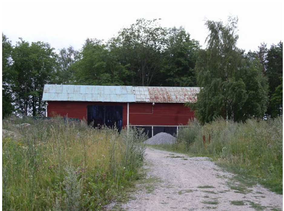
Befintlig ekonomibyggnad mitt i området. Exploatören ämnar riva denna pga att den är i dåligt skick. Detta görs i samband med nybyggnation.
