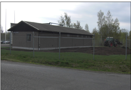
Transformatorstation på fastigheten Skövde 5:232
