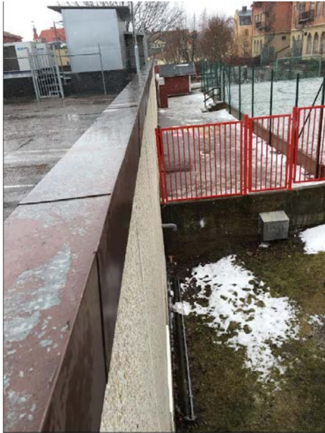
Figur 17. Skolgårdens lågpunkt och befintlig dagvattenbrunn ligger bakom det röda staketet.
