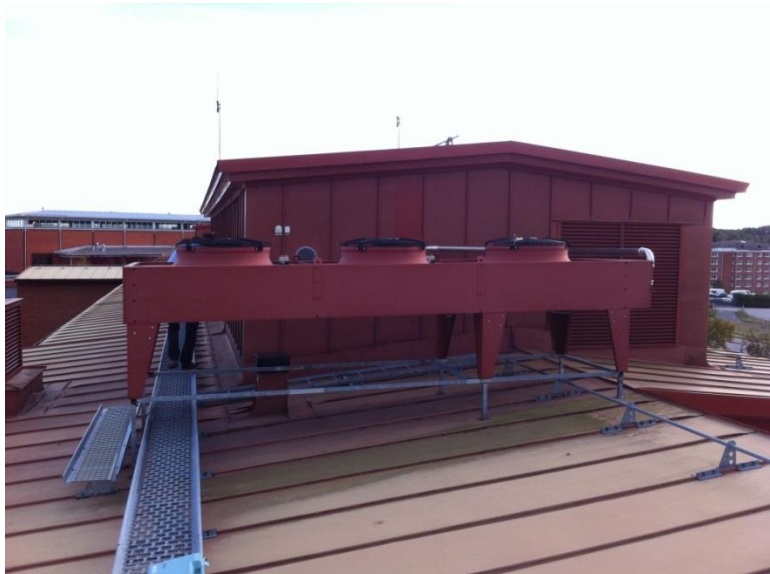
Tilluft till LB01 - Ingen åtgärd krävs
