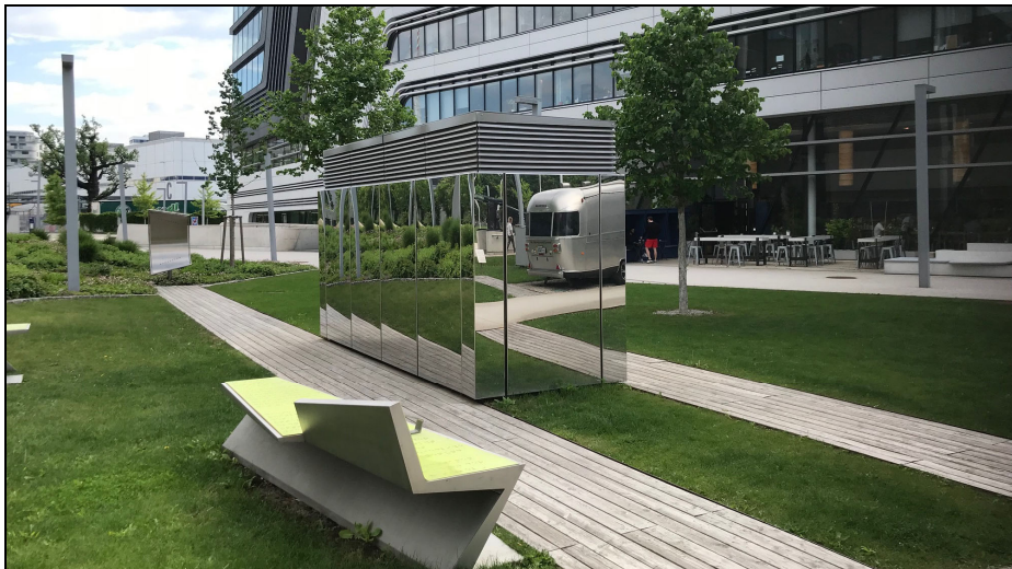
Friliggande nätstation som smälte in och stämmer med omgivning
