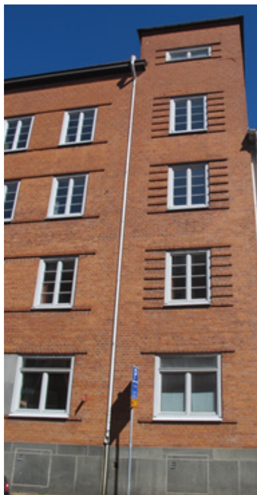
Torn i byggnadens nordvästra hörn.
