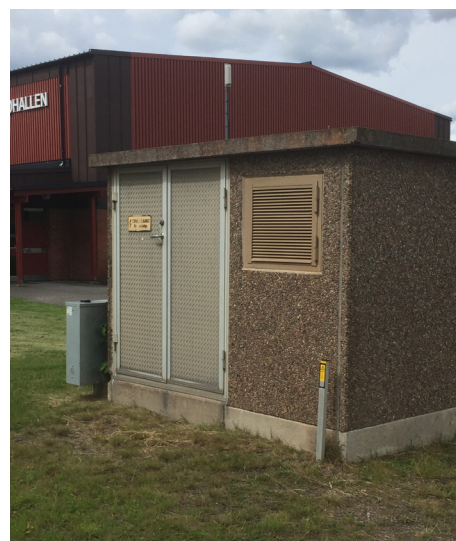
Befintlig transformatorstation, SkövdeNät AB
