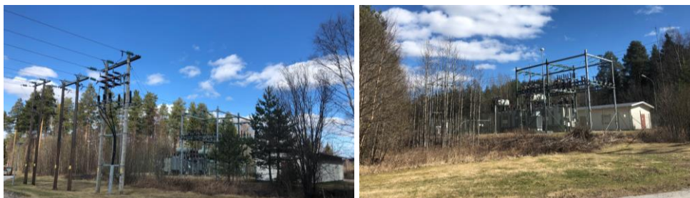
Foton på befintlig transformatorstation och komplementbyggnad/teknikbyggnad (Foto: Tyréns AB 5 maj 2020)
