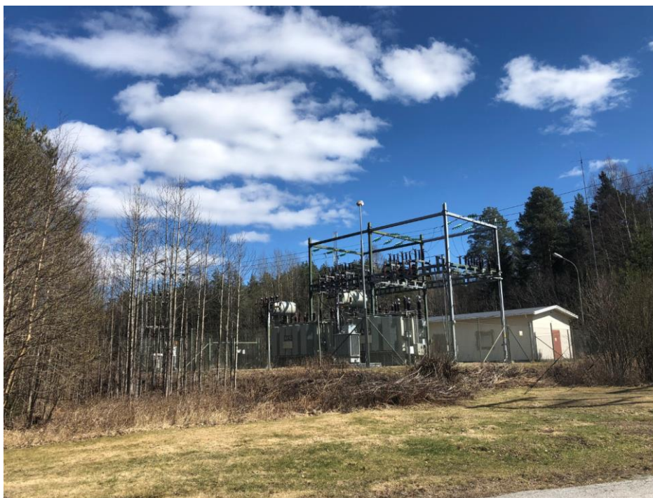
Foto på befintlig transformatorstation och komplementbyggnad/teknikbyggnad (Foto: Tyréns AB 5 maj 2020)
