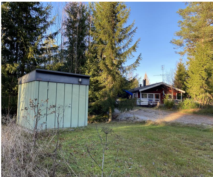
Befintlig transformator i områdets västra del
