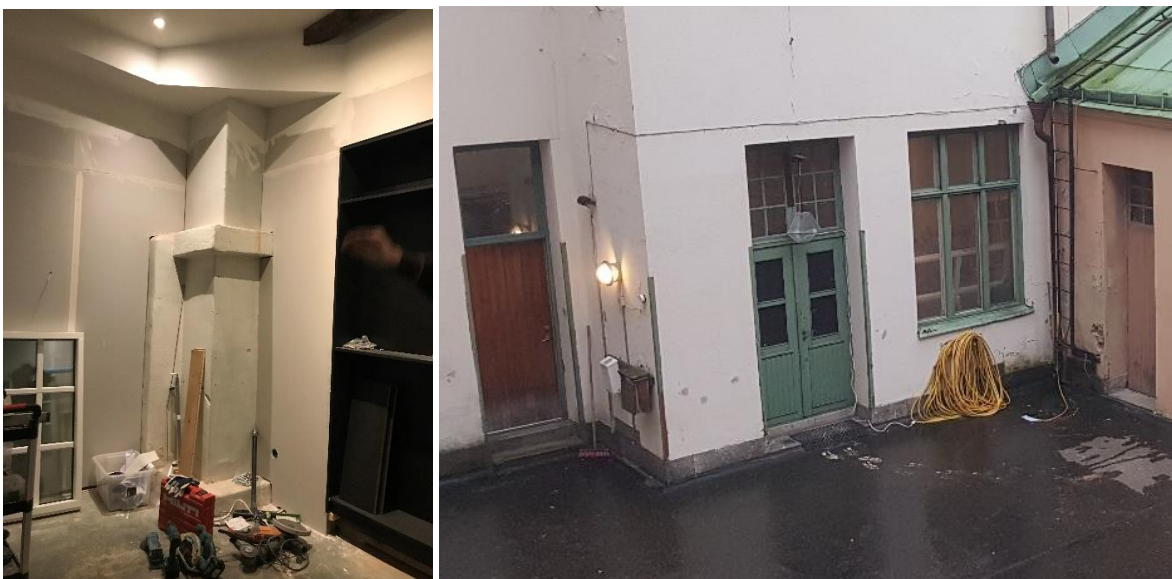
Inbygd ventilatio och vattenledningar i magasinlokalen. Magasinlokalens exteriör.
