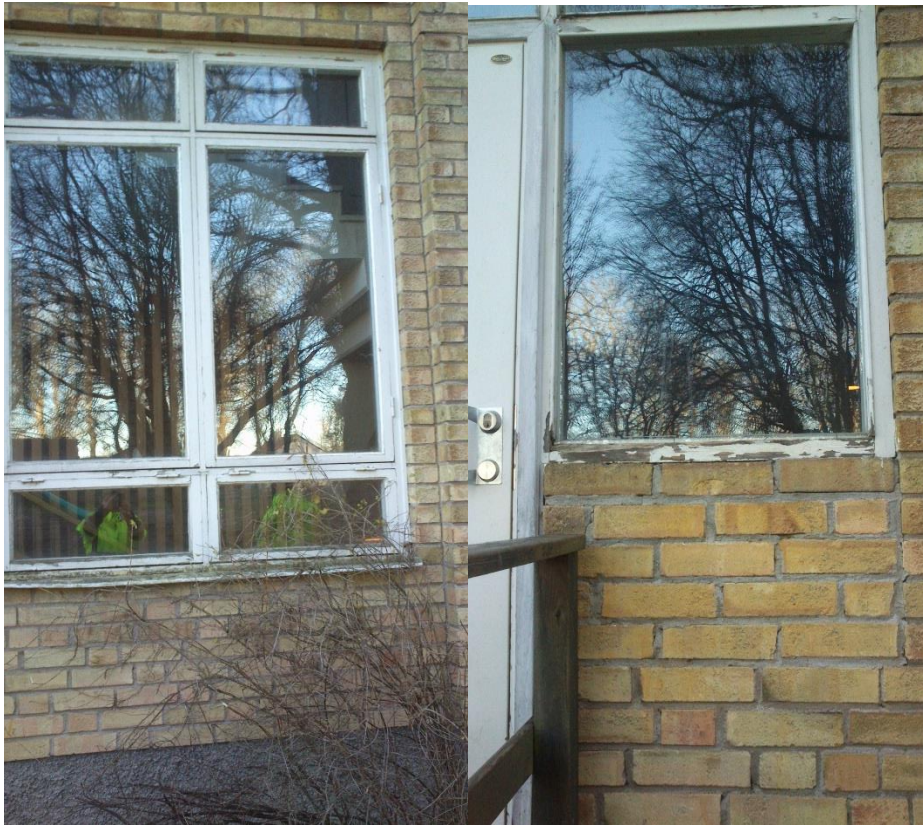
Figur 4. Visar fönsternas skick på Släbroskolans huvudbyggnad.
