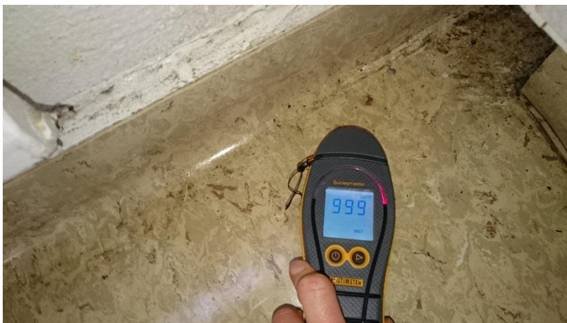
Figur 42. Bilden ovan visar att det indikeras mycket hög fuktkvot i golvet i hörnet i rum 111 Skolkök, där det även har runnit på väggen.
