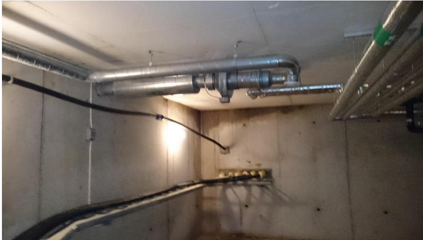
Figur 33. Fuktinträngning i FRD 024.
