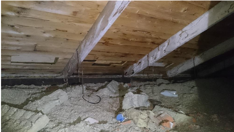
Figur 15. Spår av fukt i kattvind.
