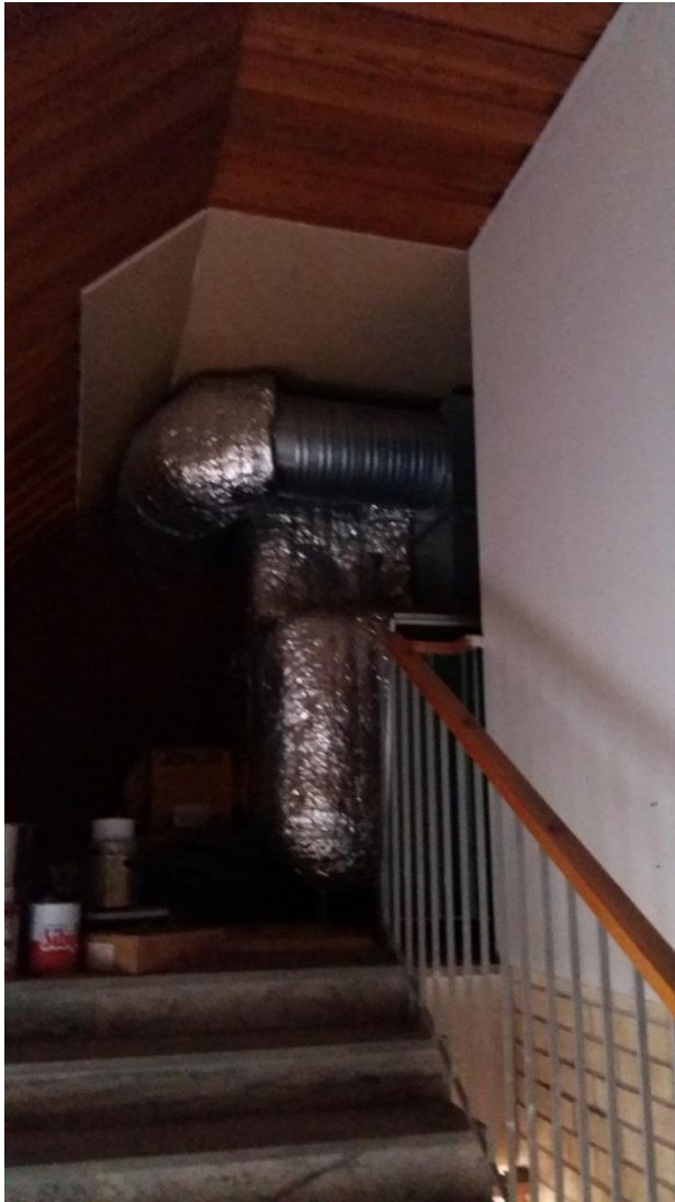
Figur 2. kanaldragningar i öppen del längst upp i trapphuset
