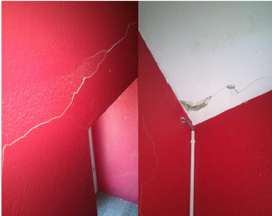
Figur 5. Visar spricka i yttervägg i det mindre trapphuset i Släbroskolans huvudbyggnad.
