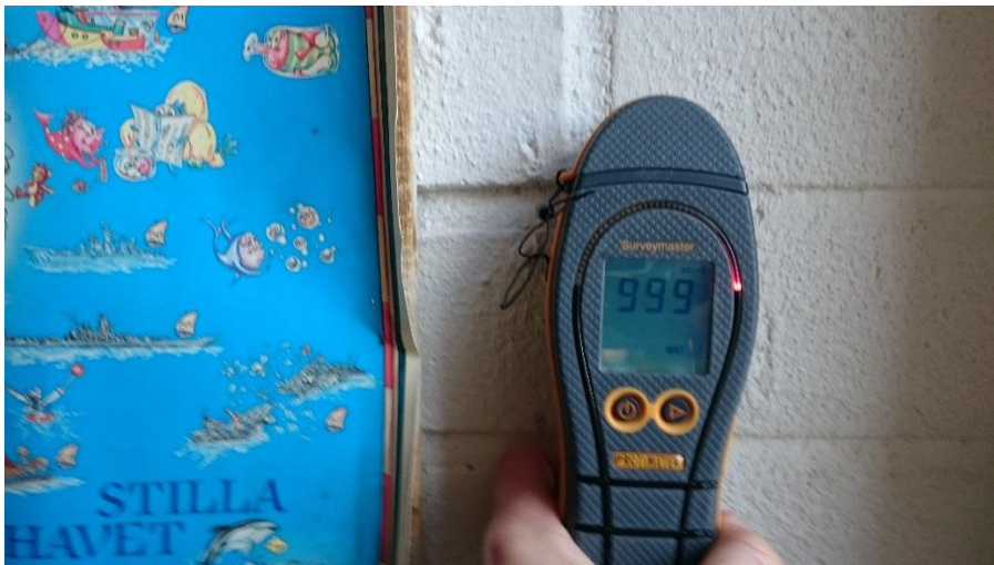
Figur 46. Indikerande mätning visar på mycket hög fuktkvot i väggen i rum 120 Textilslöjd under det skadade innertaket.
