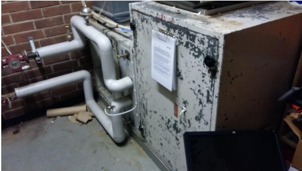
Figur 44. Ventilationsaggregat för tilluft är gammalt och slitet.
