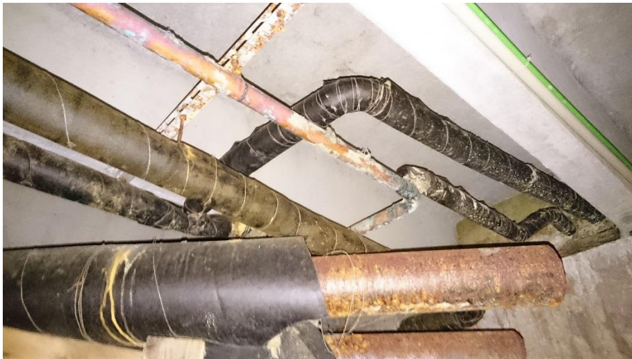
Figur 51. Gamla rör och ledningar i källaren.
