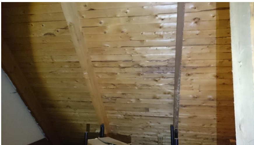
Figur 7. Spår av fukt på insidan av yttertaket, rum Vind 305.
