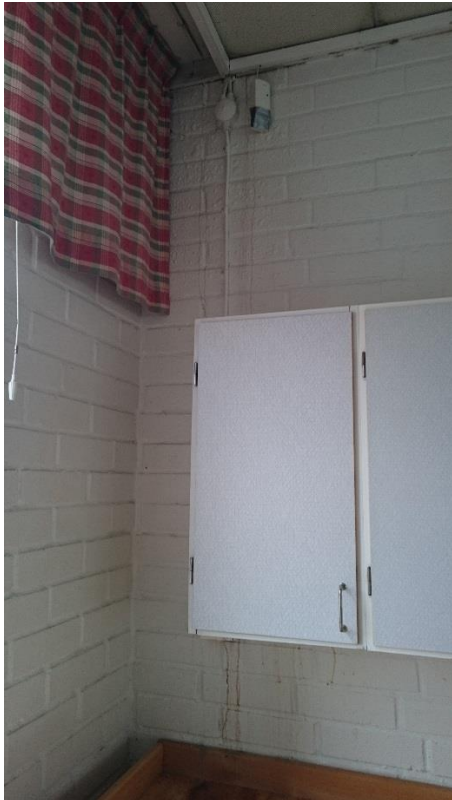
Figur 40. Något har runnit utmed väggen i rum 111 Skolkök.
