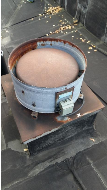
Figur 24. Frånluftsfläkt på taket.
