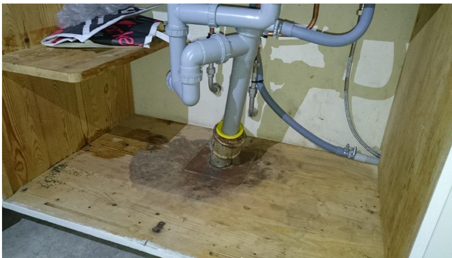
Figur 16. Rörsoppling i dåligt skick, vindsvåningen.
