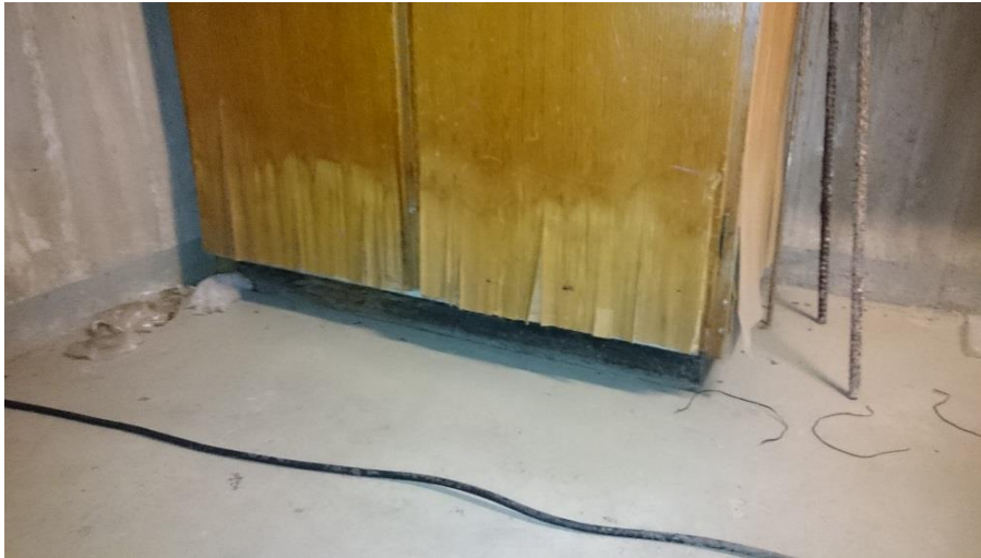
Figur 50. Spår efter en översvämning i källaren.
