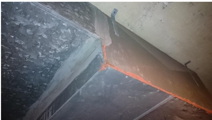
Figur 38. Grå fog innehållande asbest, rum 011 FRD.
