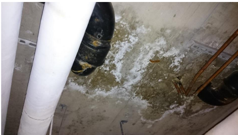
Figur 32. Pågående fuktskada i tak, rum 005 Fläktrum.
