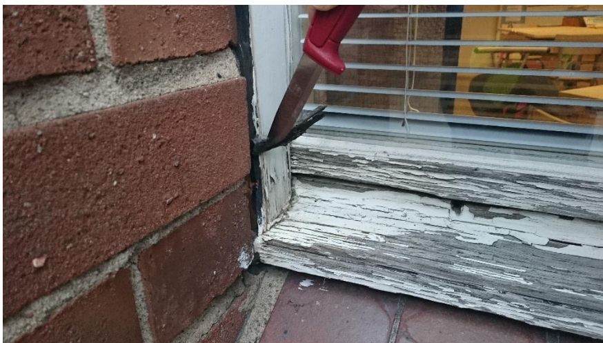
Figur 36. Mjukfog runt fönster innehållande PCB.
