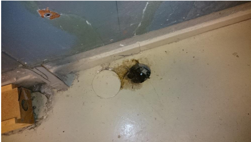
Figur 17. Visar kapad kabel med spår av olja.
