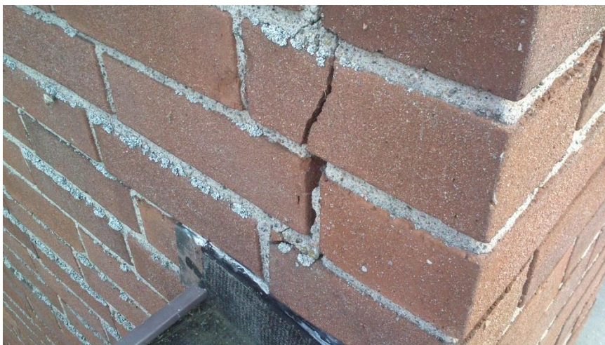
Figur 27. Tegelfasad i behov av renovering.
