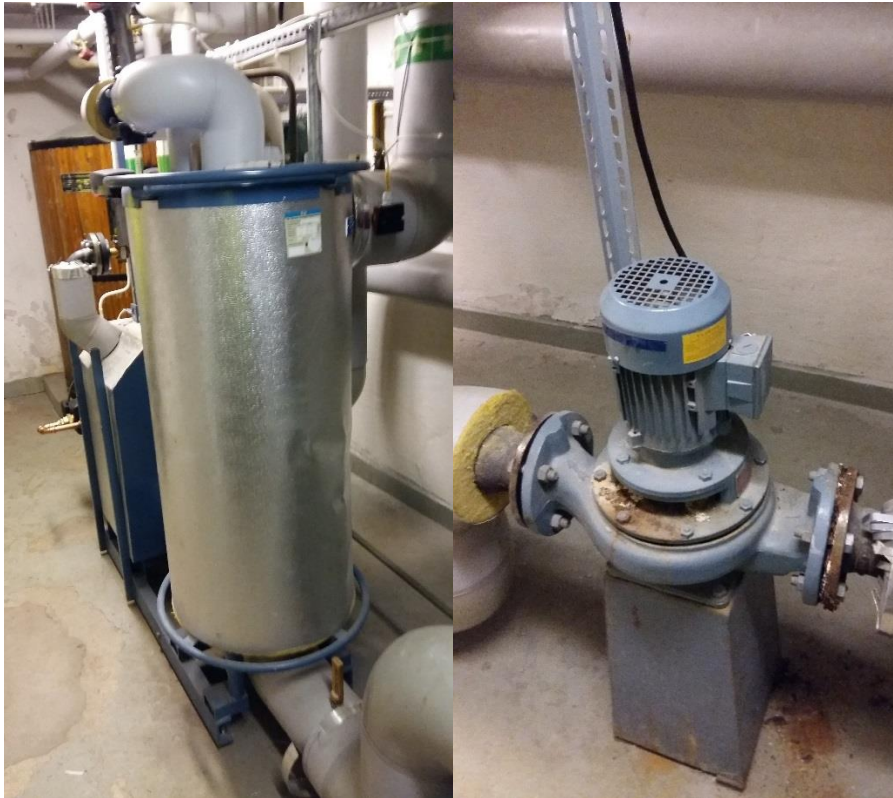
Figur 3. Värmeväxlare och cirkulationspump
