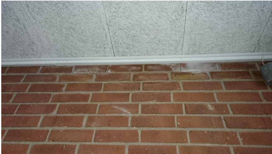
Figur 35. Spår av fukt vid taket i rum 167.
