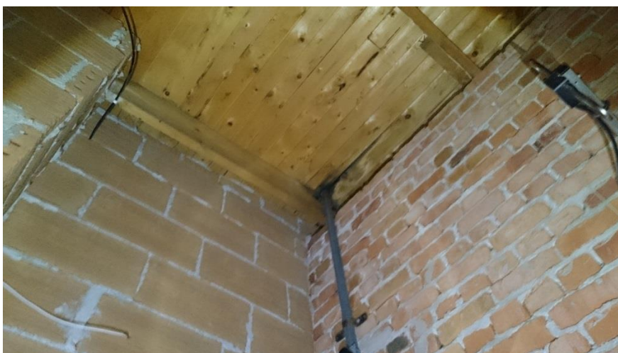
Figur 8. Spår av fukt i fläktrum 5.2.
