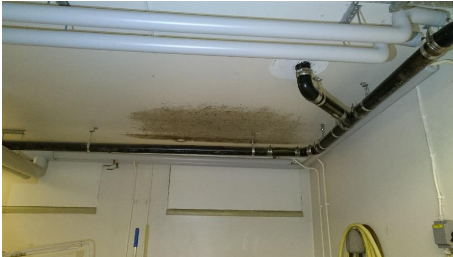
Figur 13. Tidigare fukt- och mögelskada i taket, rum 011 Förråd.
