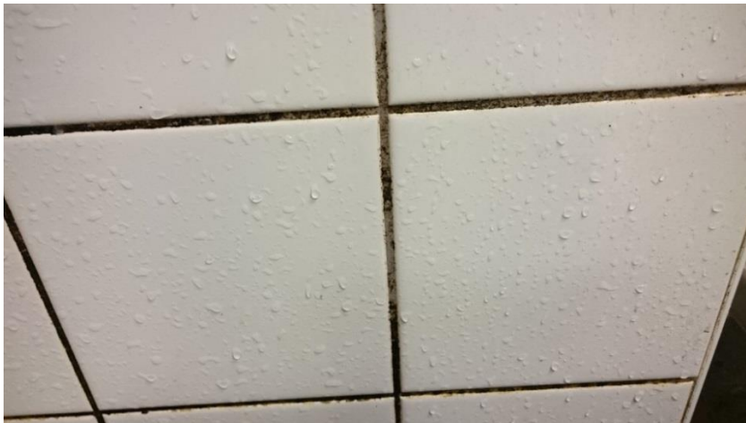
Figur 31. Svartmögel på väggen, diskrum 101.
