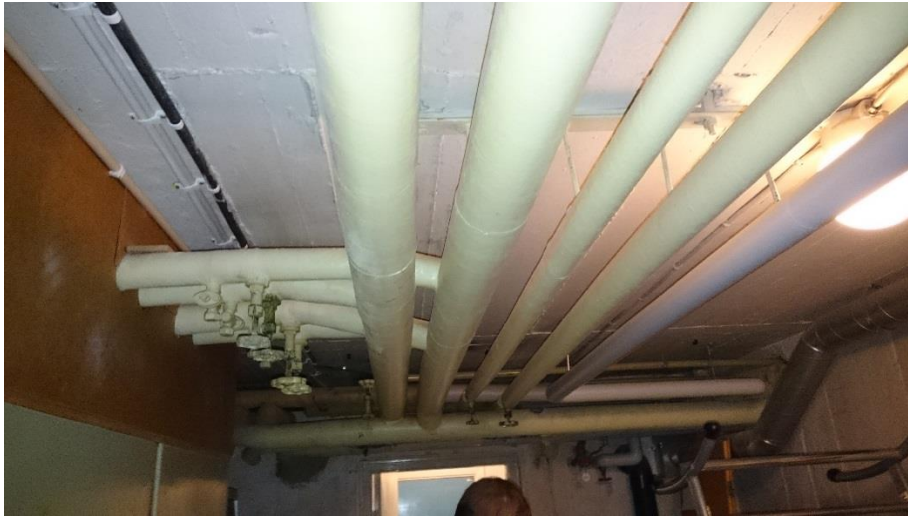
Figur 9. Rörkrökar och T-avgreningar i källaren, innehållande asbest.
