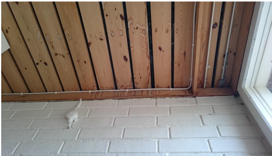
Figur 45. Indikationer på fukt i taket i rum 120 Textilslöjd.
