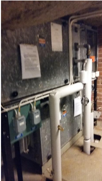
Figur 23. Tilluftsaggregat i källaren.
