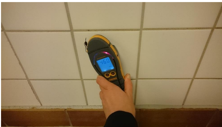
Figur 21. Fuktmätningar indikerar på fukt i yttervägg och golv vid yttervägg i rum 1.5 duschrum.
