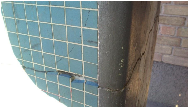
Figur 12. Sprickbildning i en bärande pelare.
