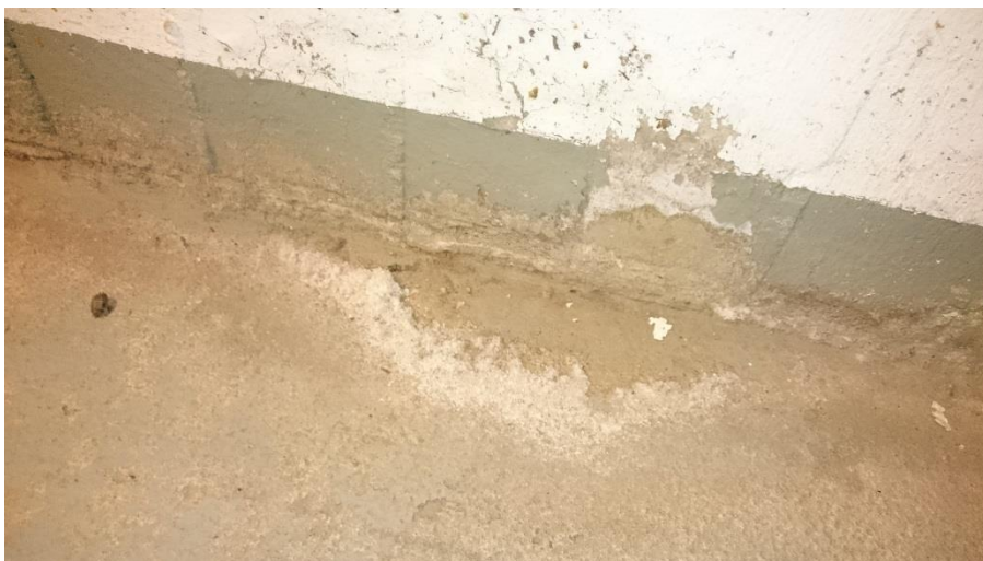
Figur 49. Spår av fukt på golvet i källaren.
