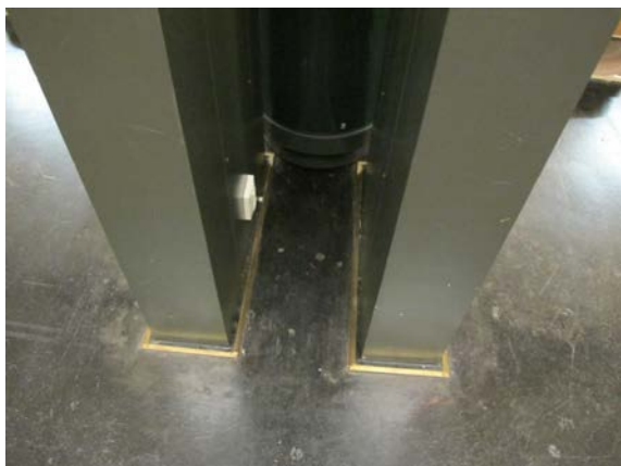
Mässingsskenor runt pelare.
