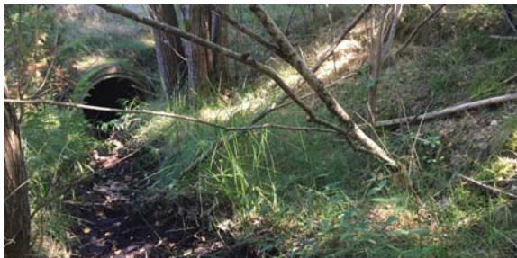
Befintligt dike och kulvert inom E 1 markerat område i detaljplanen.
