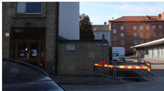
Befintlig nätstation i angränsning till HSB:s hus inom Slottsplatsen 17. 2019-09-23
