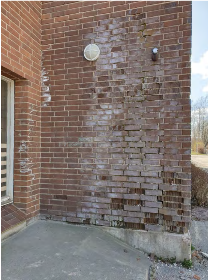
Högstadieskolan, skadad tegelmur (genomträngning från trasig dagavvattning)
