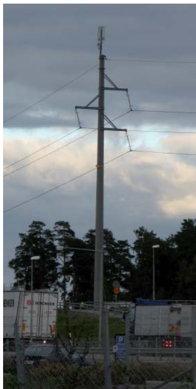
Vattenfall Regionnät AB: s 130 kV högspänningskablar i luftledning
