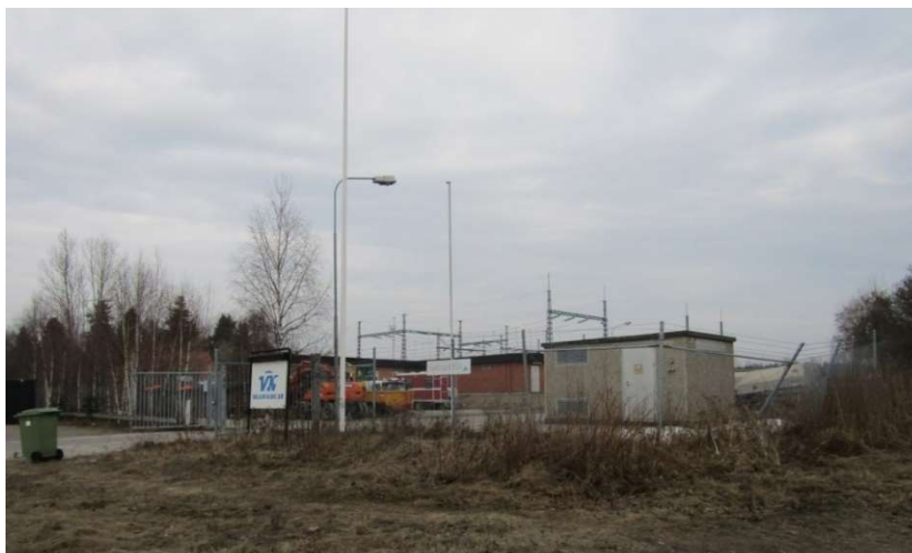
Bild från ställverket på Karlslund 5:2
