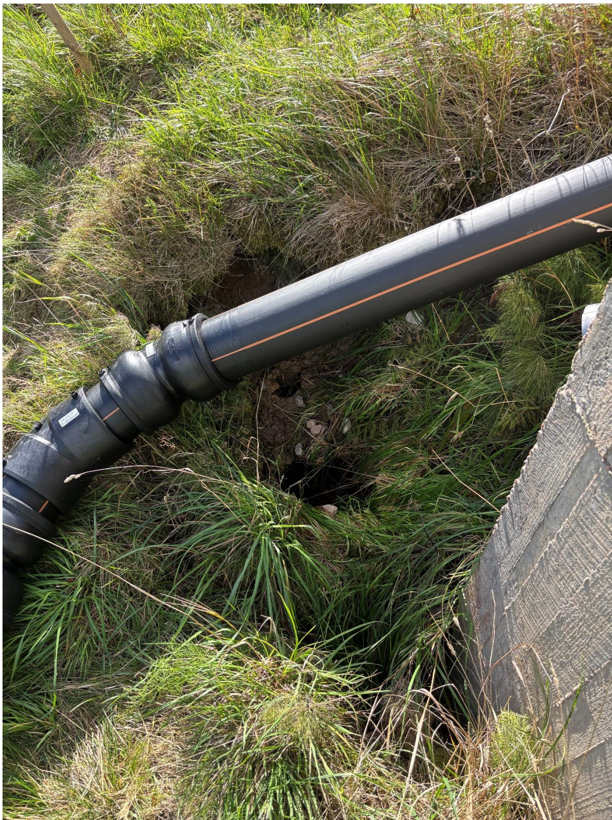
Figur 6, Erosionsskador på grund av utsläpp från takavvattning vid det sydöstra hörnet av befintligt reningsverk
