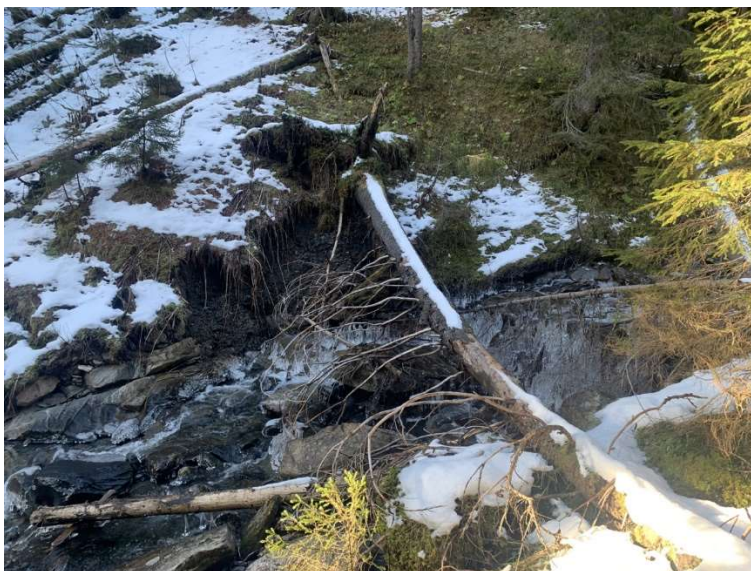
Figur 16. Erosionsskada och kullfallna träd i Vikbäckens ravin ca 120 m nedströms Vikliftens dalstation och utanför planområdet (foto Tyréns, 2023-10-20).
