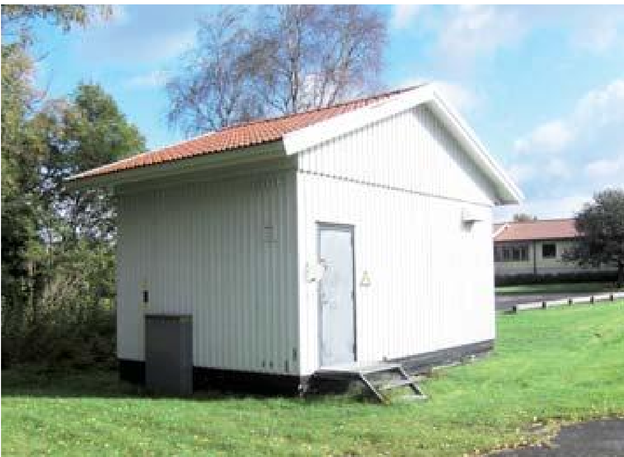
Transformatorstation i planområdet.
