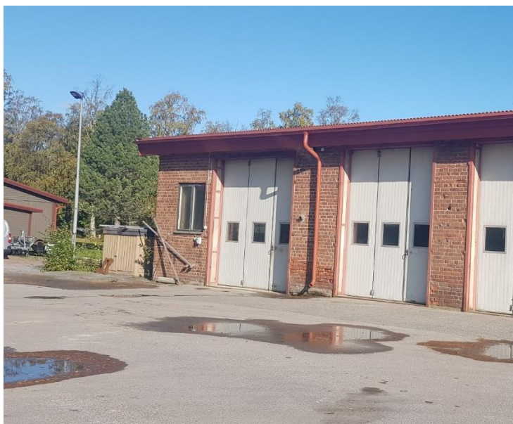
Figur 5. Exempel på bortledning av takdagvatten via stuprör och utkastare från garagebyggnaden. Dagvattnet avrinner via asfaltsytan till en gräsyta där det infiltrerar i mark. Foto: Daniel Eriksson, Tyréns.
