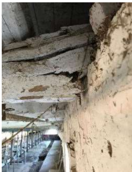
Ruttna balkar i stallbyggnaden.
