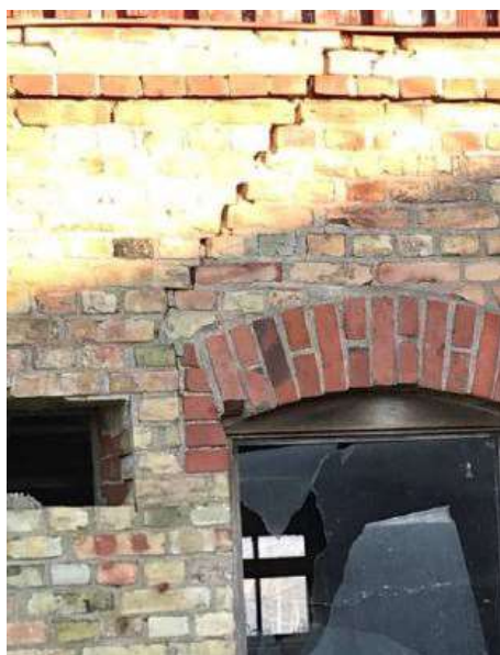
Frostsprängning och söndervittrat tegel på stallbyggnaden.
