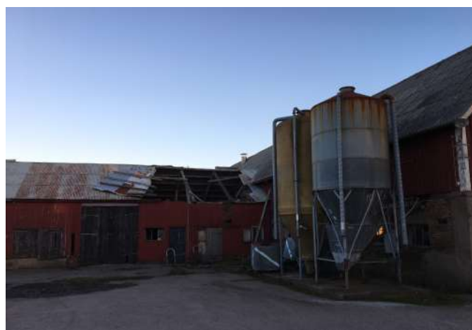
Förbindelsebyggnadens takkonstruktion är förfallen.
