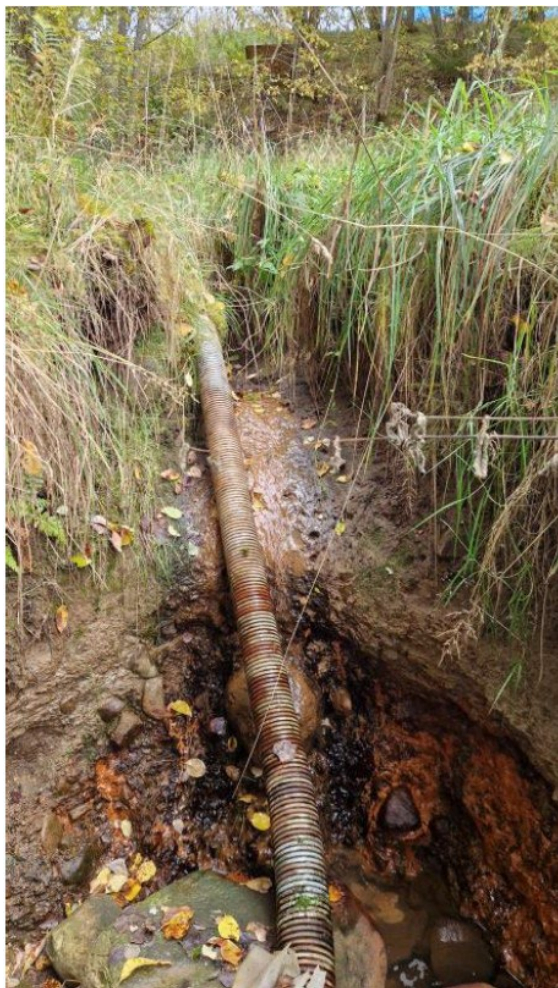
Dräneringsdiket direkt öster om industrifastigheten. Diket har erosionsskador och dräneringsledningen är blottlagd. Diket måste åtgärdas och erosionsskyddas.
