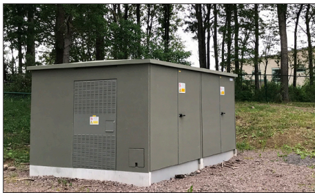
Transformatorstation brevid skolskogen till Trädgårdsstadens skola, etapp 2.
