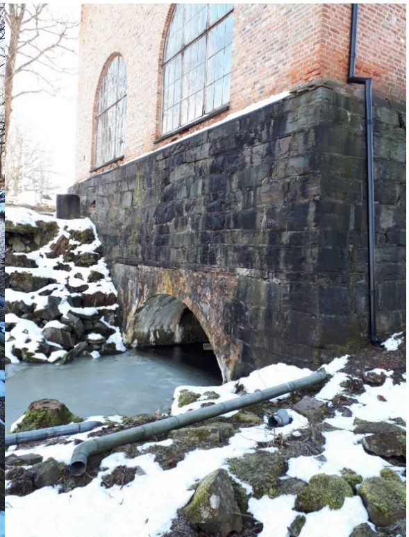
Utloppet tar bort möjligheten att röra sig runt byggnaden
