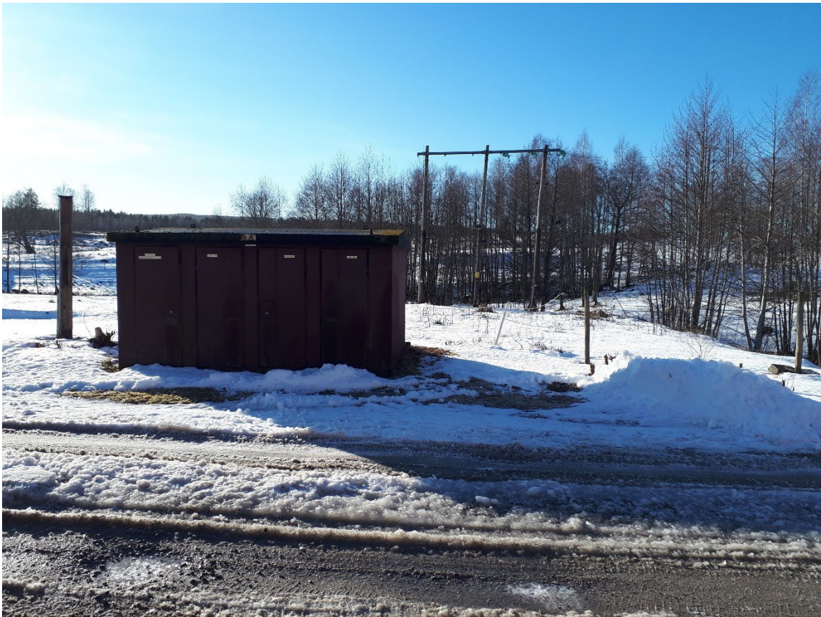
Elnätstationen i anslutning till planområdet i söder
