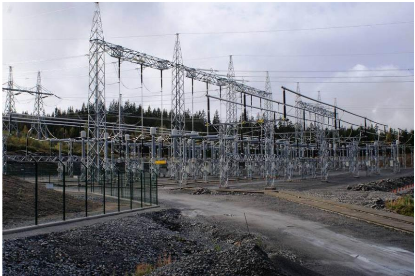
Exempel på 400 kV AC ställverk
