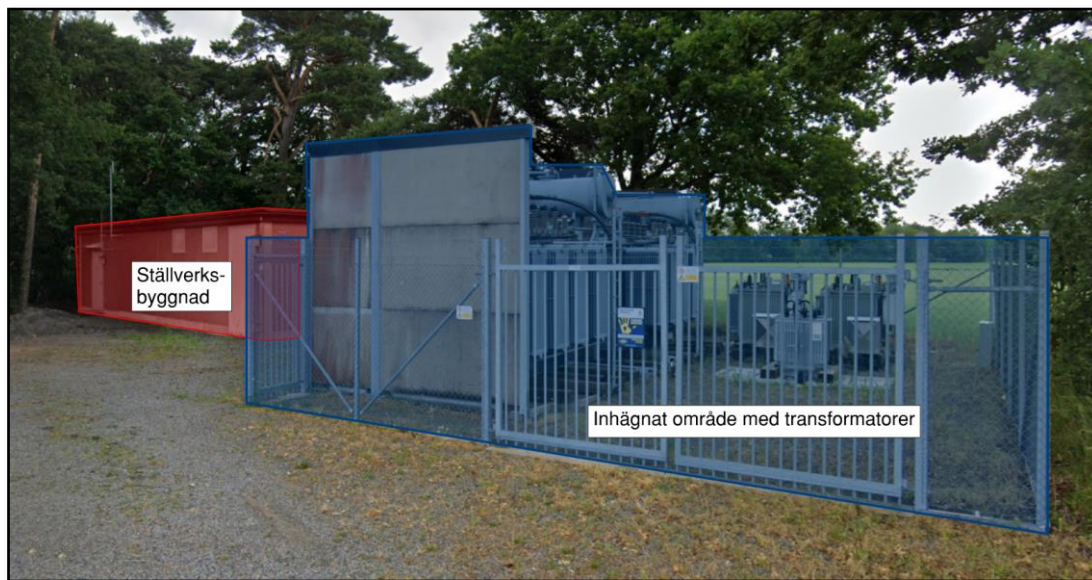
Figur 8. Bild på befintlig fördelningsstation, vy från Mellanvägen. Ställverksbyggnaden i bakgrunden/till vänster, inhägnat område för transformatorer syns till höger [10].
