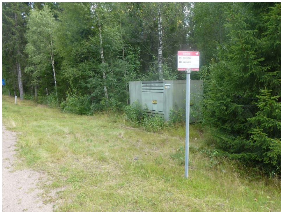
Elnätsstationen i norra delen av planområdet.
