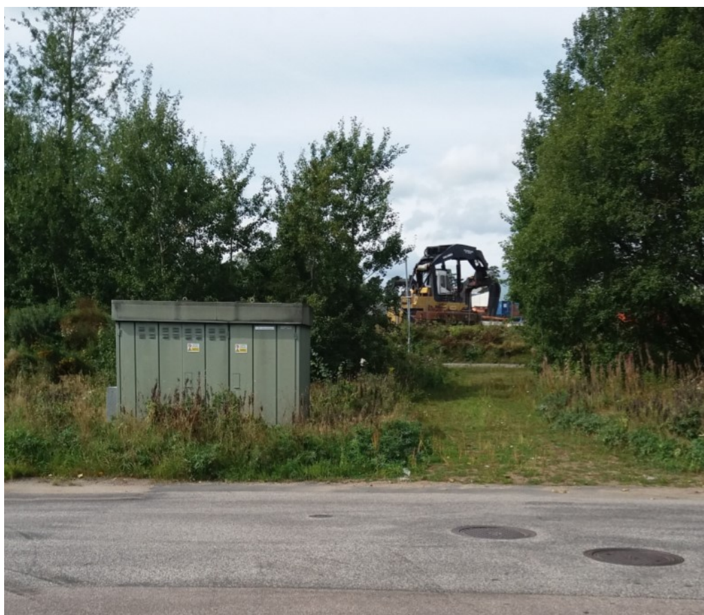
Transformatorstationen och naturområdet med nedgrävda ledningar.
