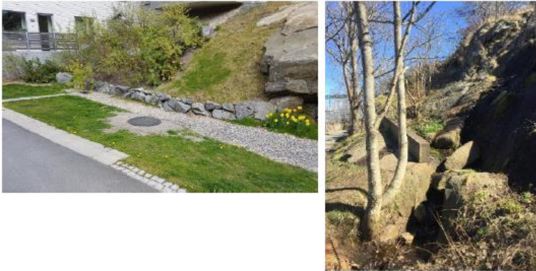
Exempel avskärande åtgärd i form av grussträng invid bergsslänten (vänster) och mur (höger), foto: Ramböll
