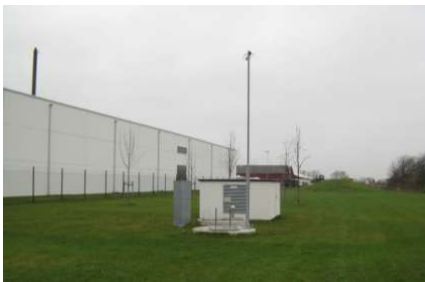
Pump- och transformatorstation
