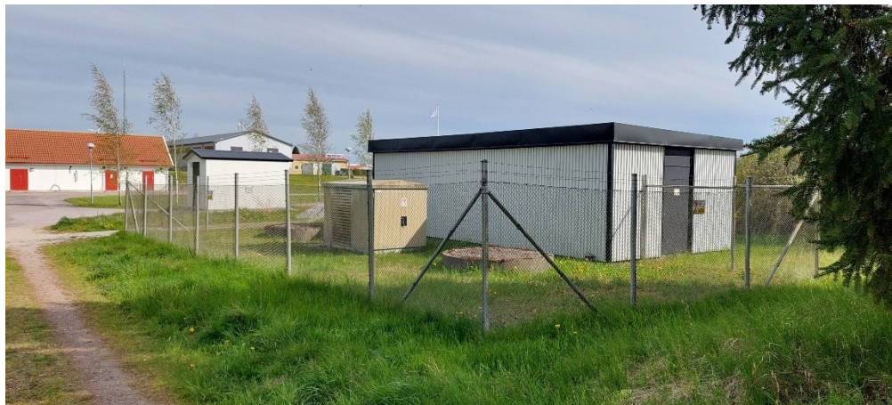
Kopplingsstation för el och pumpstation för spillvatten.
