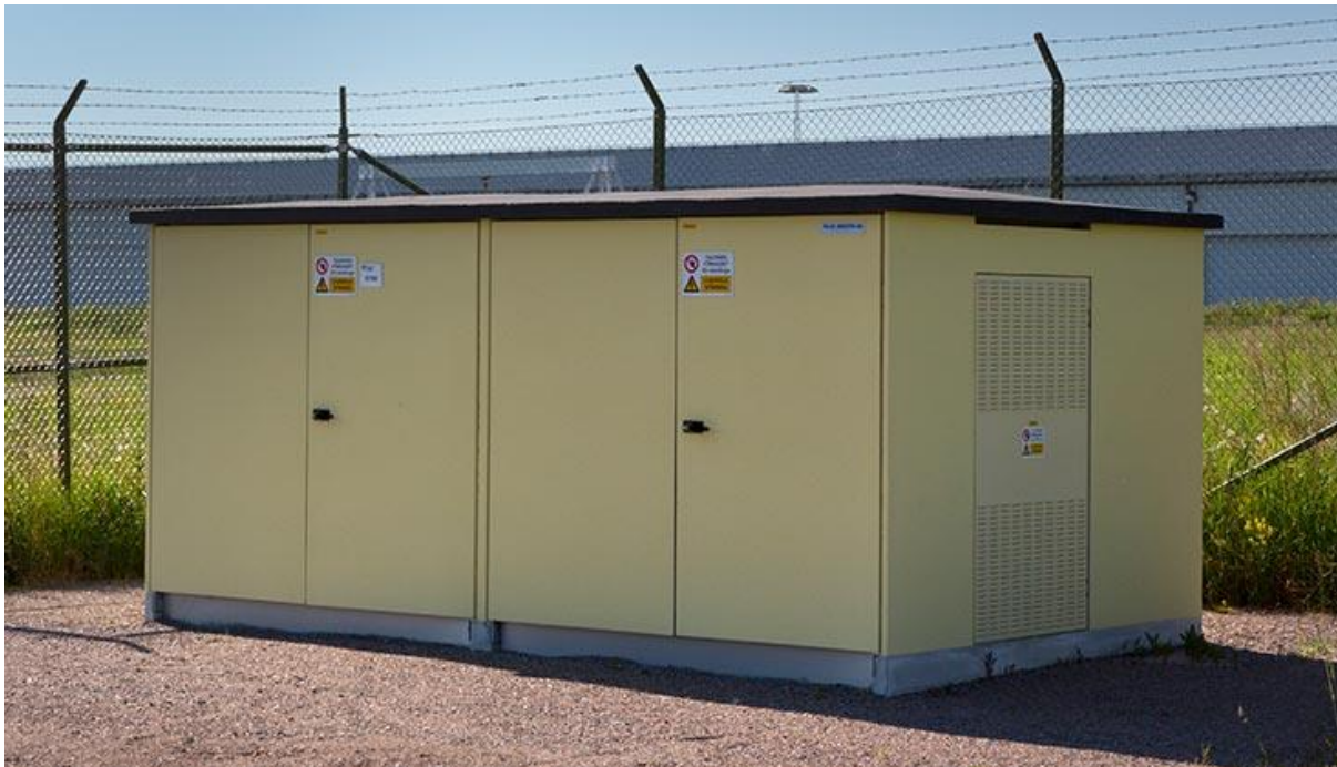
Nätstation i betong med 2st transformatorer. Vanligast i tätort och industriområden.
