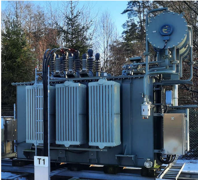
En krafttransformator, 20/10 kV i storlek 6 000 kVA eller 6 MVA.
