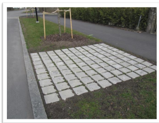
Bild över gräsarmering i Gamla stan, Motala
