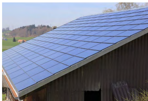
Exempel på takintegrerad solenergianläggning.
