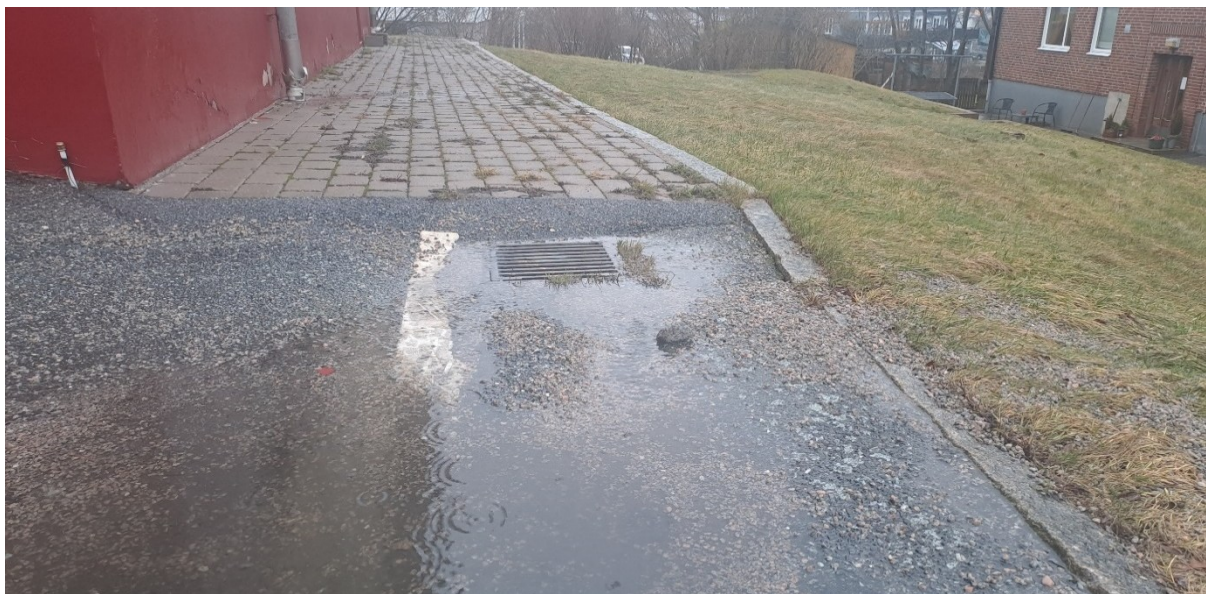
Bild som visar dagvattenbrunn på Veterinären 11 vid nederbörd.
