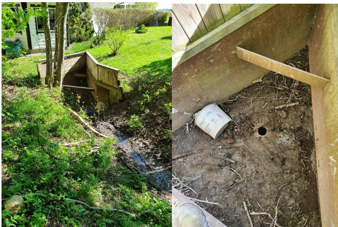
Figur 7: Bild t v och t h, invallning i lågpunkten vid fastigheten Överön 3:27. Kupolbrunn som är övertäckt av sediment.
