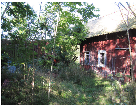
Befintlig gårdsbebyggelse är i dåligt skick.
