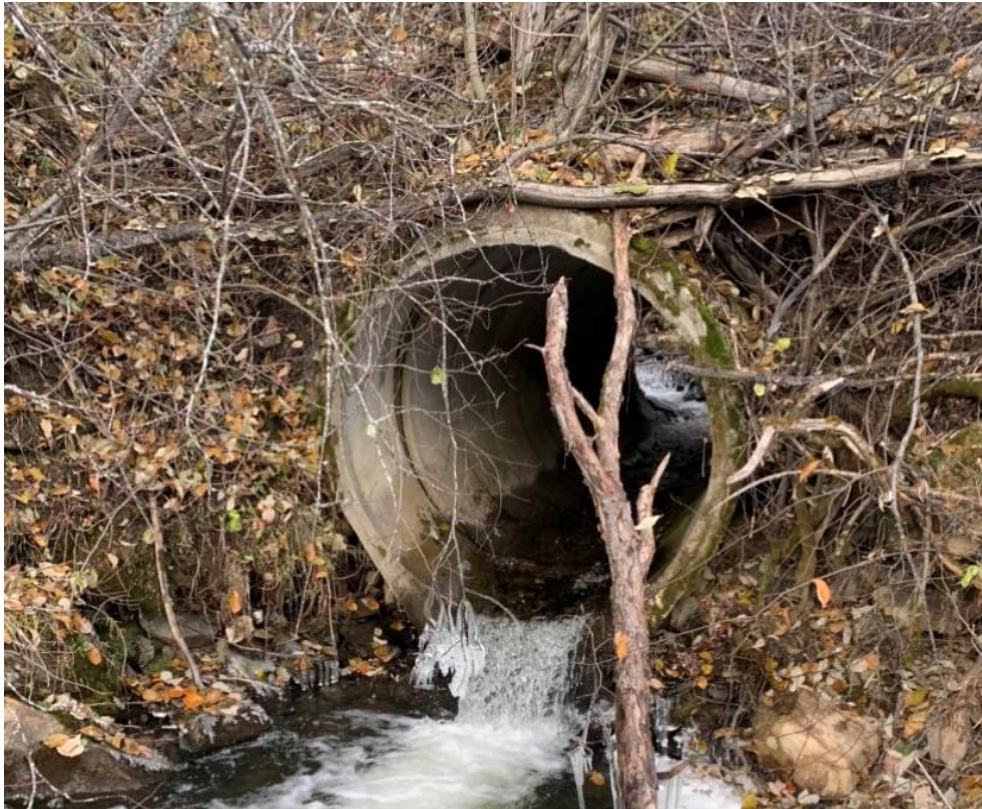
Figur 4. Betongtrumma under enskild väg söder om planområdet (punkt 10 i Figur 3). Den yttersta betongringen har delvis lossnat.
