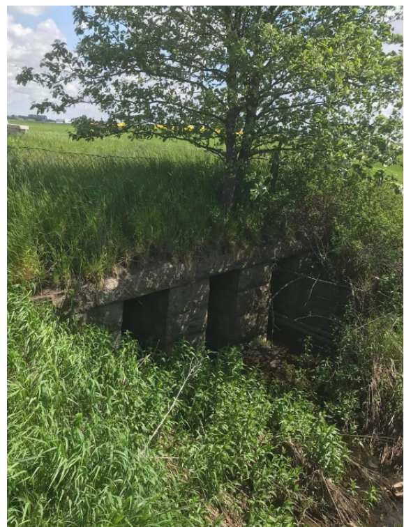
Ett av de befintliga hindren i Säbybäcken som i nuläget bidrar till översvämning vid kraftig nederbörd.
